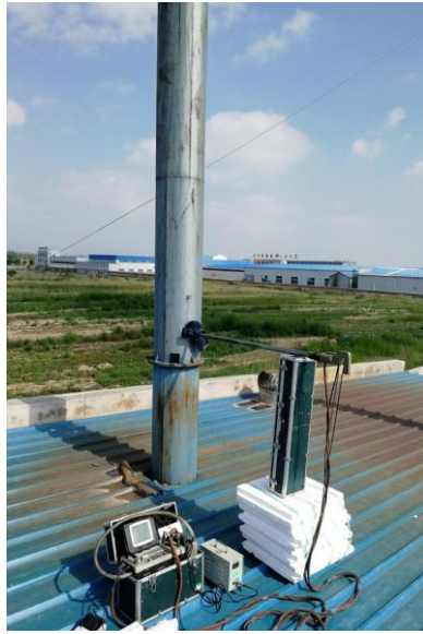
1#燃气锅炉出口
