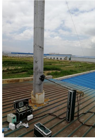
2#燃气锅炉出口
