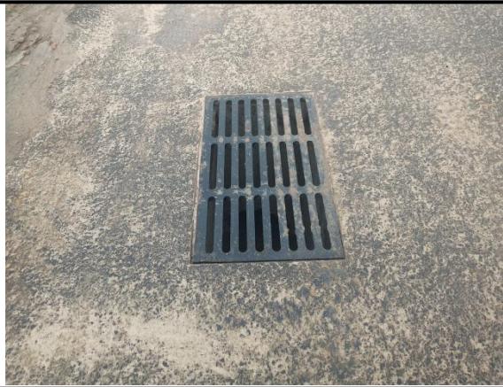
雨污分流雨水收集设施
