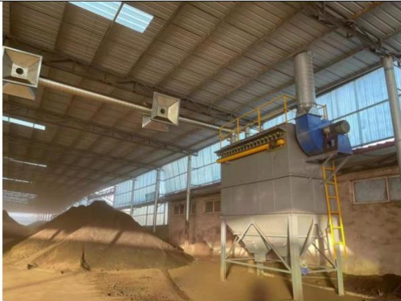
粉碎工序除尘器
