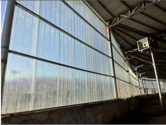
封闭发酵车间
