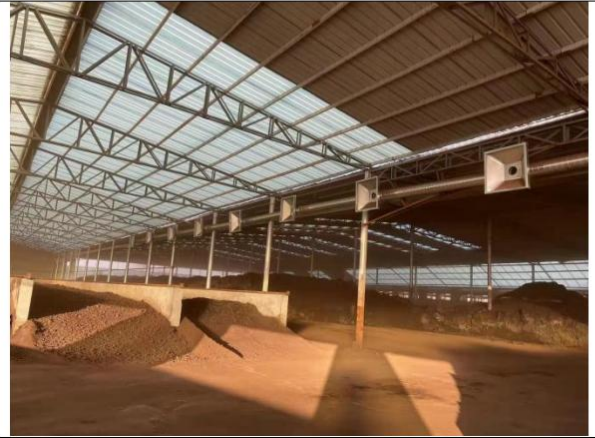
发酵过程恶臭气体集气罩及集气管道
