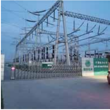
图1 清水河变电站
